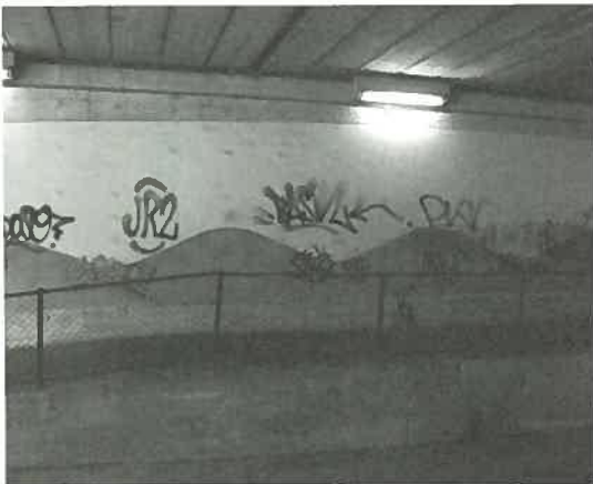
事件直後のトンネルの様子
