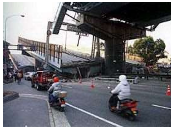
兵庫県南部地震による橋桁の落下
