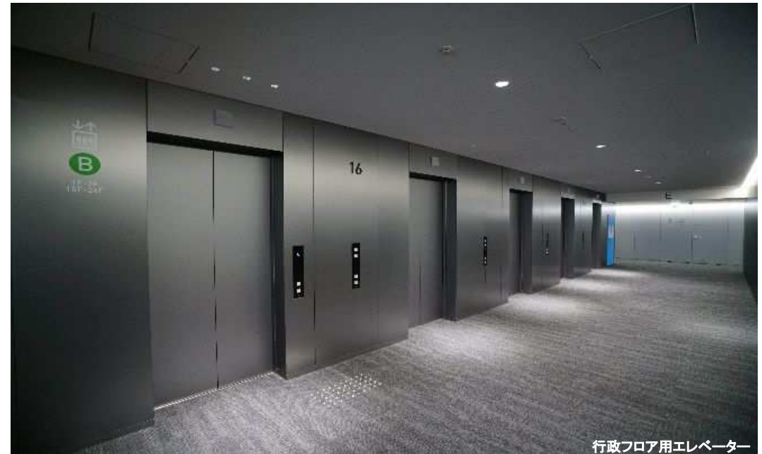
行政フロア用エレベーター
