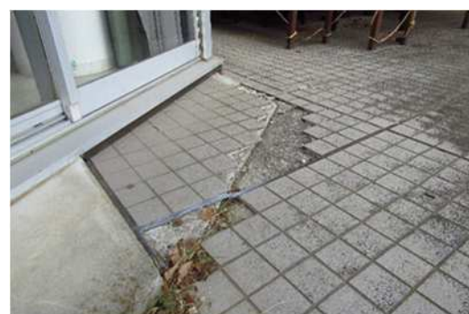
犬走りの劣化(D棟)
