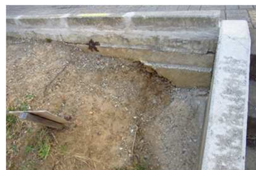
擁壁の劣化(A棟屋内運動場)
