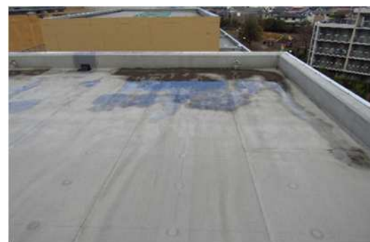
防水層の劣化(B棟)
