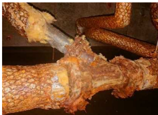
老朽化した配管
