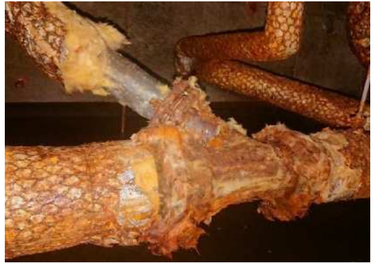
老朽化した配管
