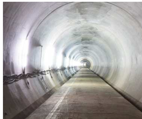
大師河原貯留管
