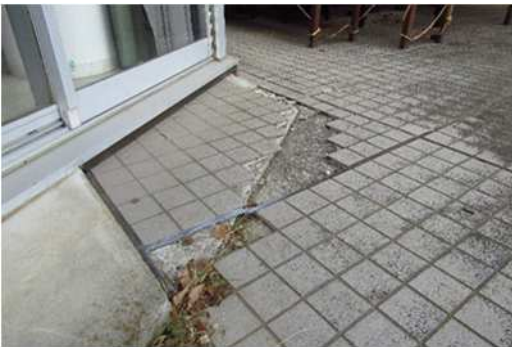
犬走りの劣化（D棟）
