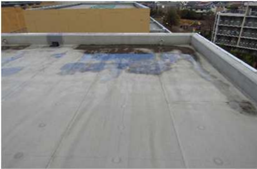
防水層の劣化（B棟）
