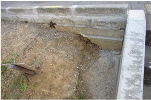
擁壁の劣化（A棟屋内運動場）
