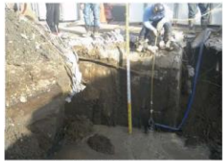
障害物の状況
