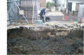
道路側の壁残出
