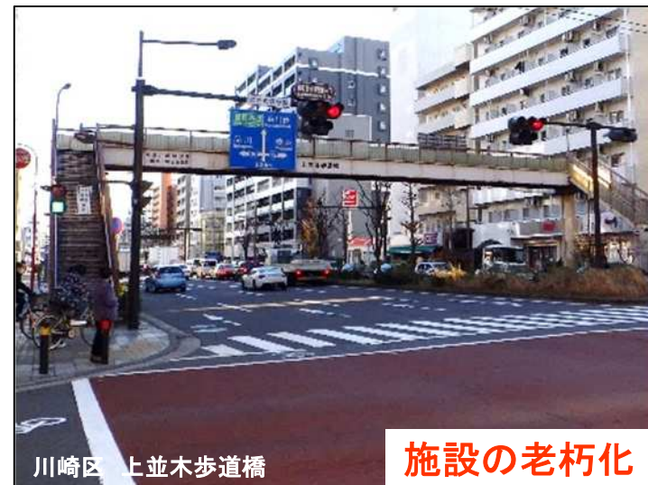
「老朽化・地震対策」A01-002((県)扇町川崎停車場ほか)
