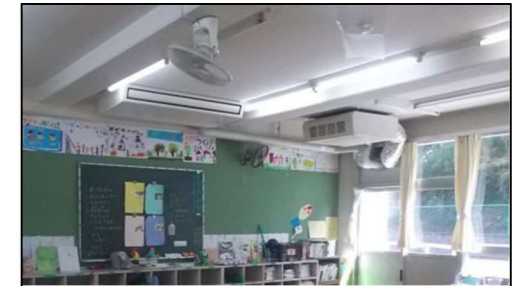
PFIで導入した空調設備（小学校）
