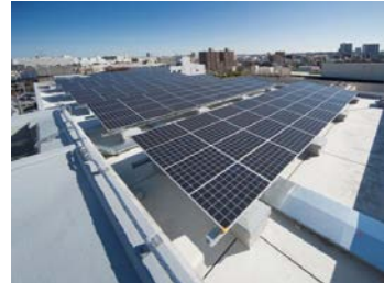
区役所屋上にある太陽光パネル
