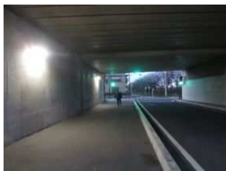
「殿町第三公園入口」 交差点高架下の照明 (国) 【H30完了】
