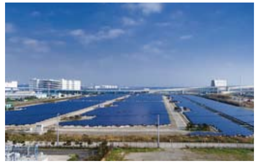
最大出力7000kWのメガソーラー「浮島太陽光発電所」 "Ukishima Mega Solar Power Plant", has a maximum generation capacity of 7,000 kW.
