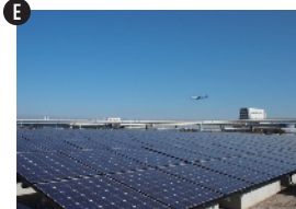
浮島太陽光発電所
