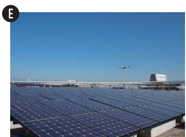
浮島太陽光発電所
