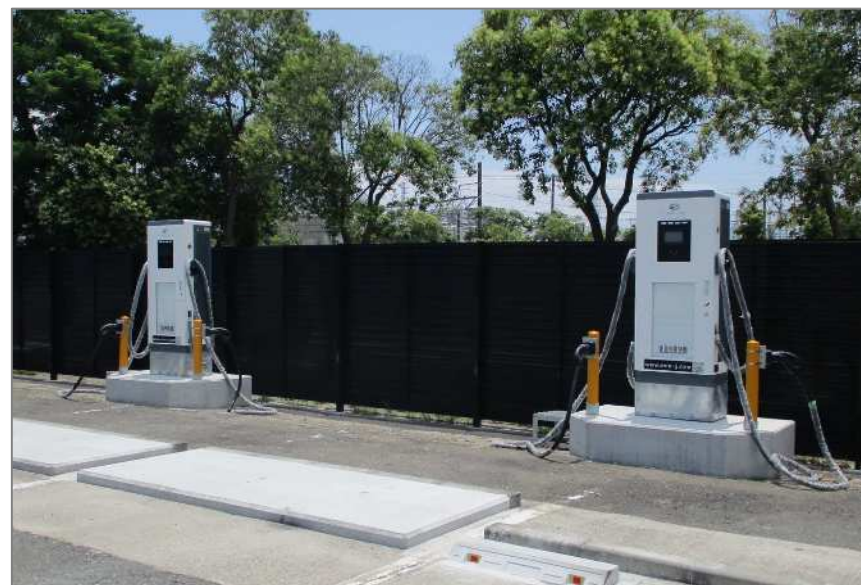
電気バス関係設備 (充電器)
