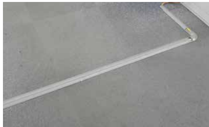
▲配線を養生するモール
