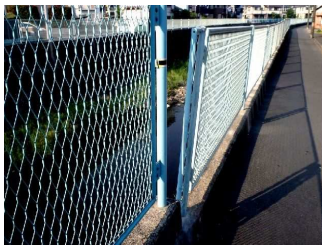
変状による護岸施設の見違い
