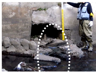
護岸背面部の空洞
