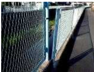
変状による護岸施設の目違い
