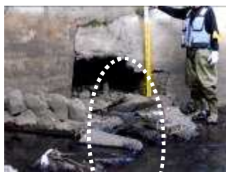
護岸背面部の空洞
