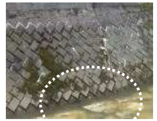
護岸の変状(ブロック隙間の拡大)
