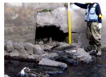
護岸背面部の空洞
