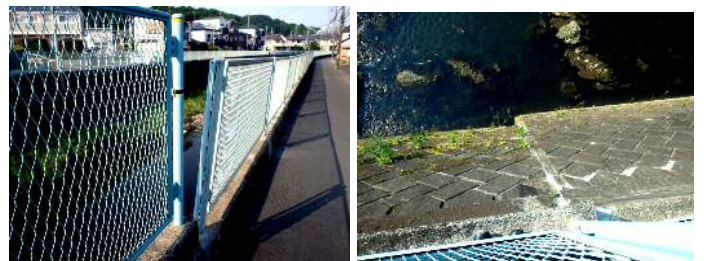
変状による護岸施設の目違い
