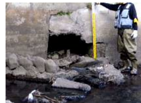
護岸背面部の空洞
