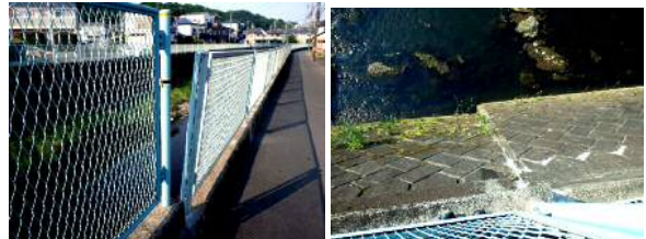
変状による護岸施設の見違い
