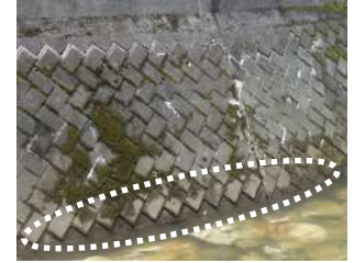
護岸の変状(ブロック隙間の拡大)
