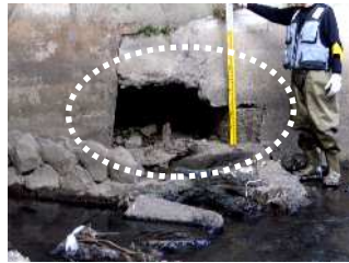
護岸背面部の空洞
