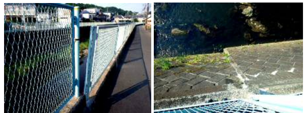
変状による護岸施設の目違い
