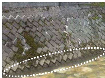
護岸の変状(ブロック隙間の拡大)
