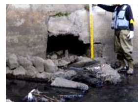
護岸背面部の空洞
