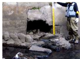
護岸背面部の空洞
