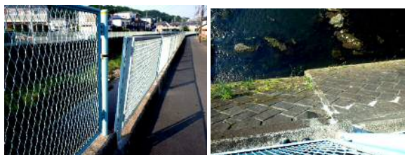
変状による護岸施設の見直し
