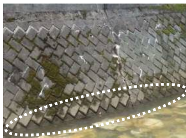
護岸の変状(ブロック隙間の拡大)
