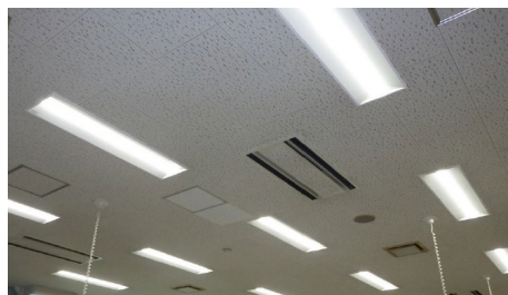
LED照明(宮前小学校)
