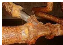
老朽化した配管
