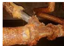
老朽化した配管
