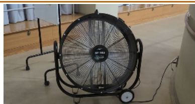
大型扇風機による換気（宮前スポーツセンター）
