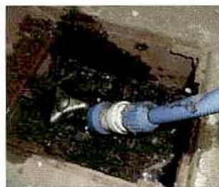
▲ 水の溜まった埋設型散水栓
