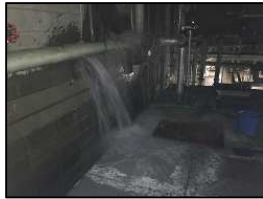
（プール循環配管の破断）
