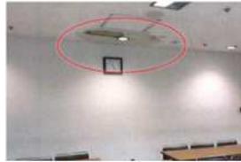
（漏水による会議室天井の欠落）
