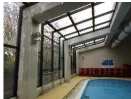
（プール壁面の塗装の剥離）
