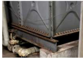
（受水槽の発錆、配管経年劣化）
