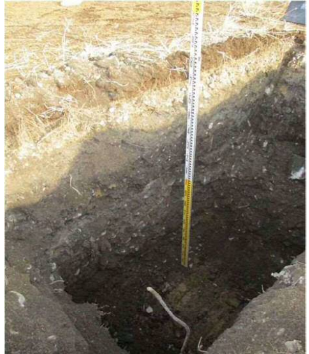
南側面 GL-1m付近に鉄筋あり
