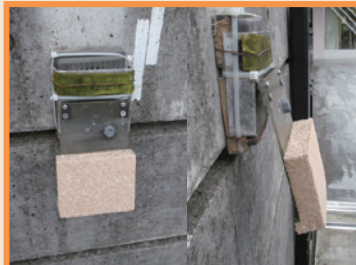
設置場所が屋外のため、劣化も進んでいます
