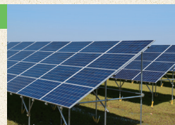
太陽光パネル
