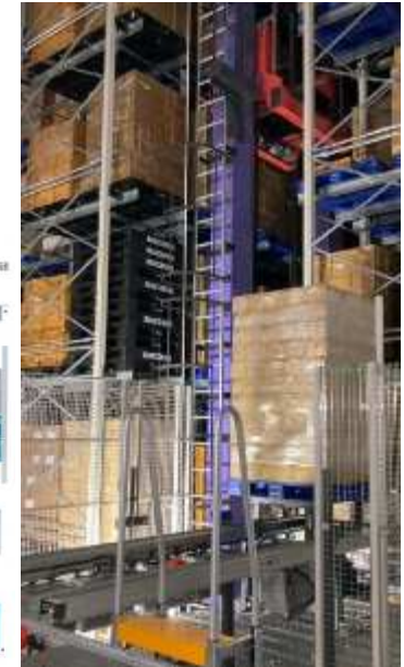
自動化した冷蔵倉庫
