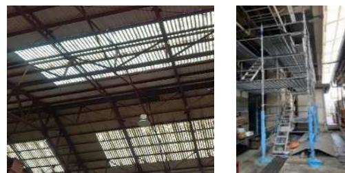
青果卸売場棟天井(左)と改修工事(右)
