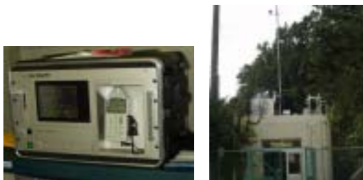
図 3 航空機騒音観測装置 (麻生区)
