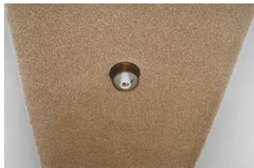
天井：ひる石（吹付け石綿）
