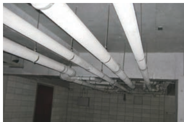
給排水管：セメント円筒管
