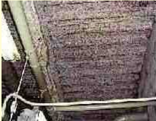
天井に吹き付けられたアスベスト
