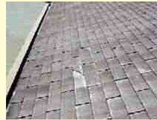
住宅屋根用化粧スレート
