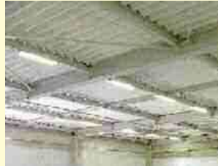
屋根裏の折板石綿断熱材
