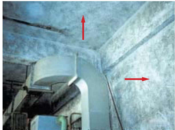
吹付けアスベスト・アスベスト含有吹付けロックウール (吸音用)
