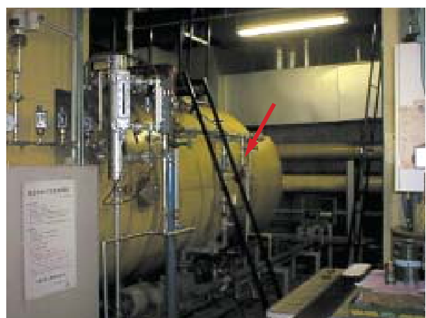
アスベスト含有保温材 (ボイラ外周部)
