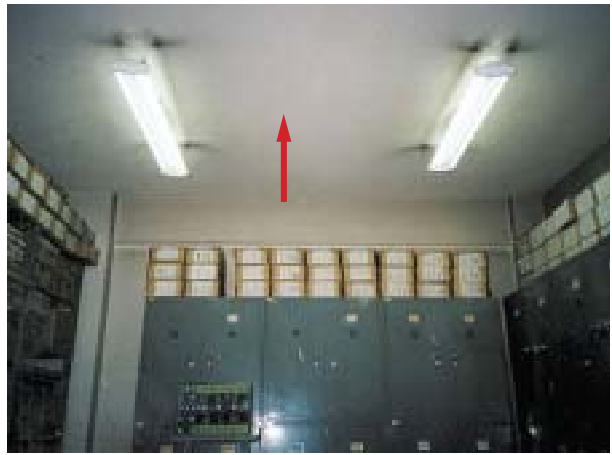
アスベスト含有バーミキュライト吹付け (天井)
