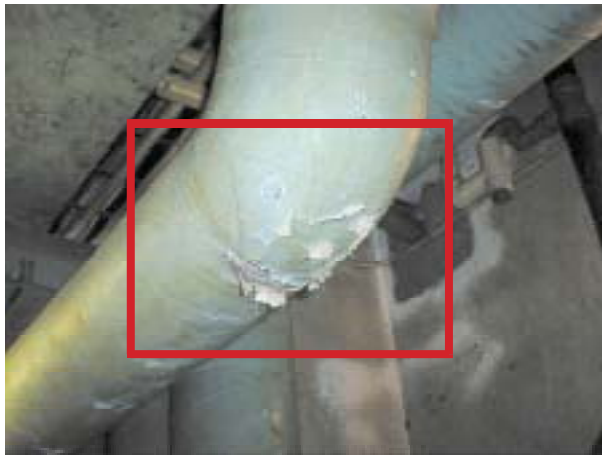
アスベスト含有保温材 (配管曲がり部)
