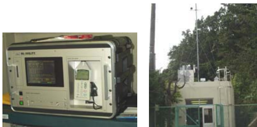
図2 航空機騒音観測装置(麻生区)
