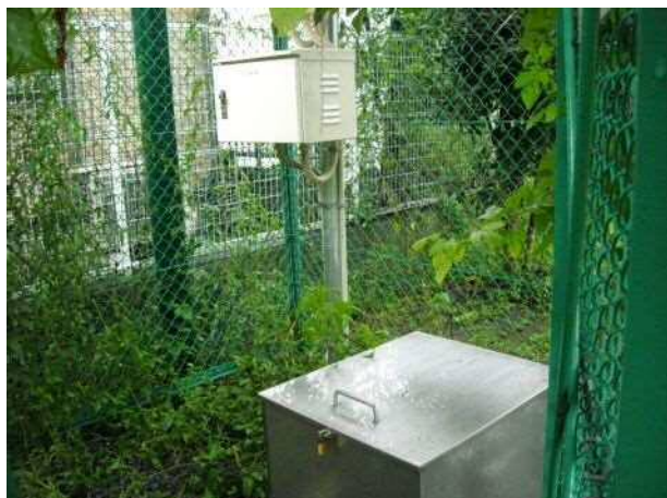
地下水位観測所の水位計
