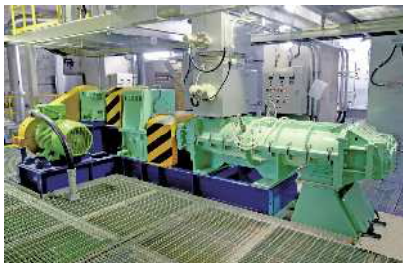
飛灰安定化装置
