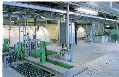
排水処理設備
