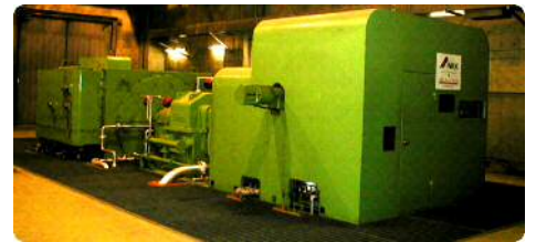
タービン発電機
