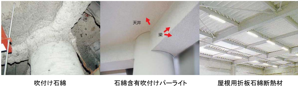
図2 飛散性アスベスト建材例
