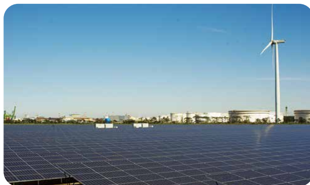
扇島太陽光発電所
