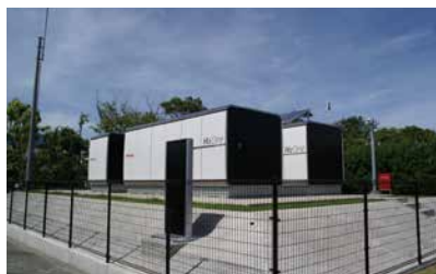
自立型水素エネルギー供給システムの設置
