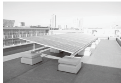
国際交流センターに設置された太陽光発電設備
