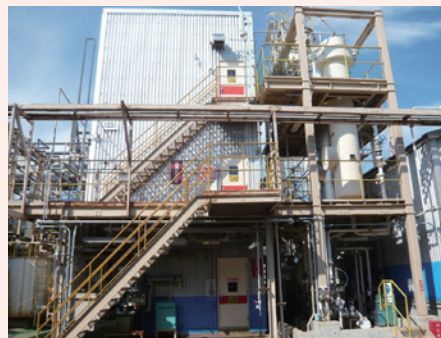
ホスゲン製造設備外観
