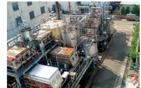
排水汚泥を焼却するインシネレーター装置
