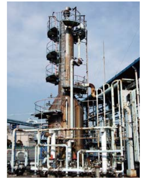
揮発性炭化水素回収装置 (VRU装置)
