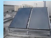
太陽熱利用給湯
